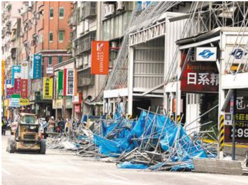
圖2 103年1月12日捷運站施工架倒塌
