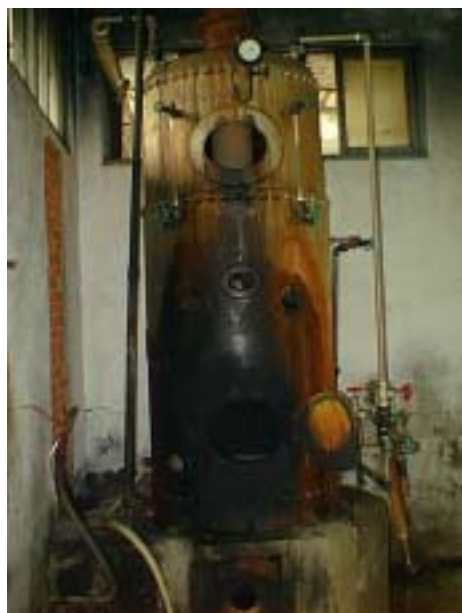
備註：豎型鍋爐
